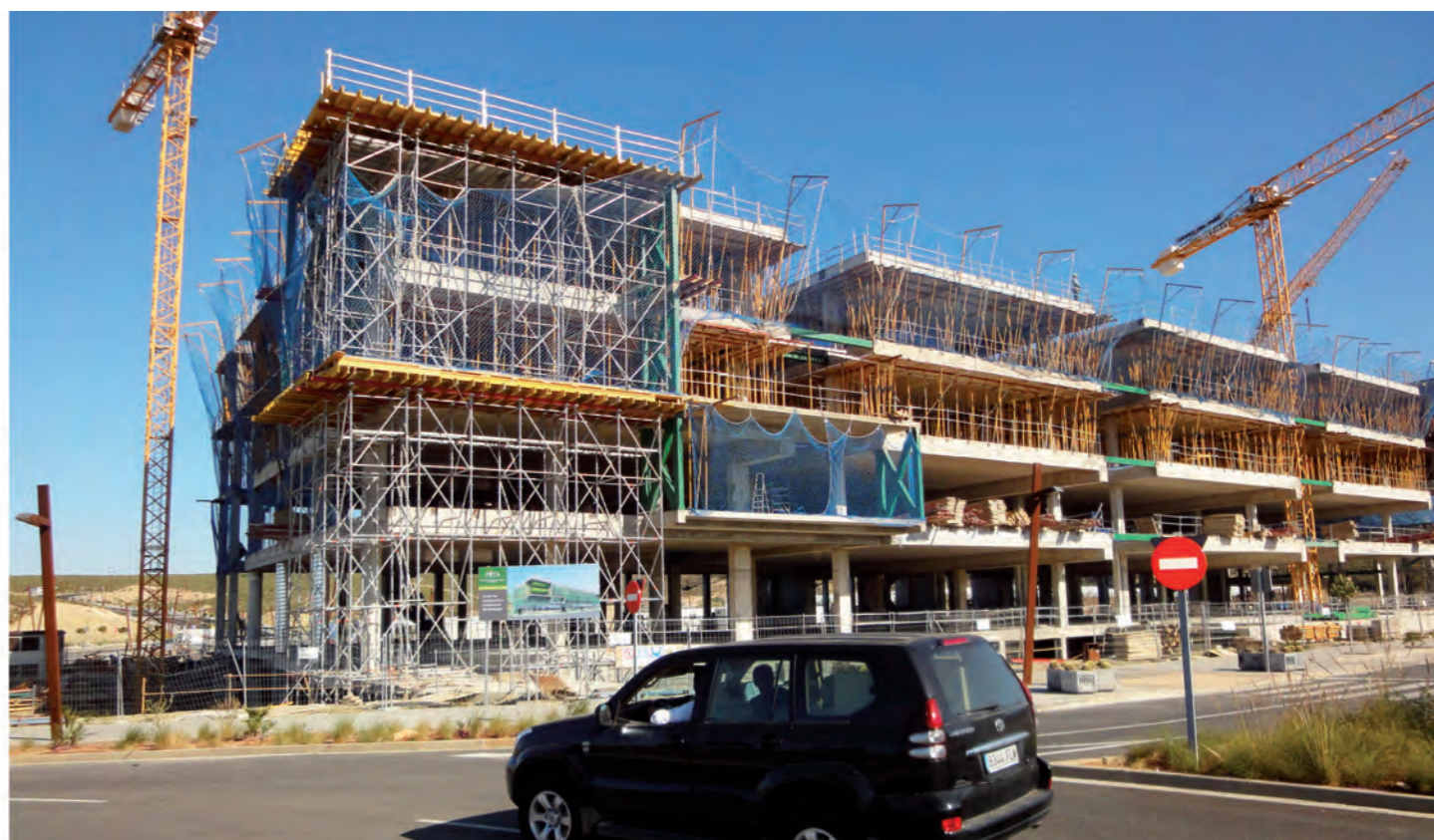
Estado de las obras del Centro de Negocios en el parque tecnológico
